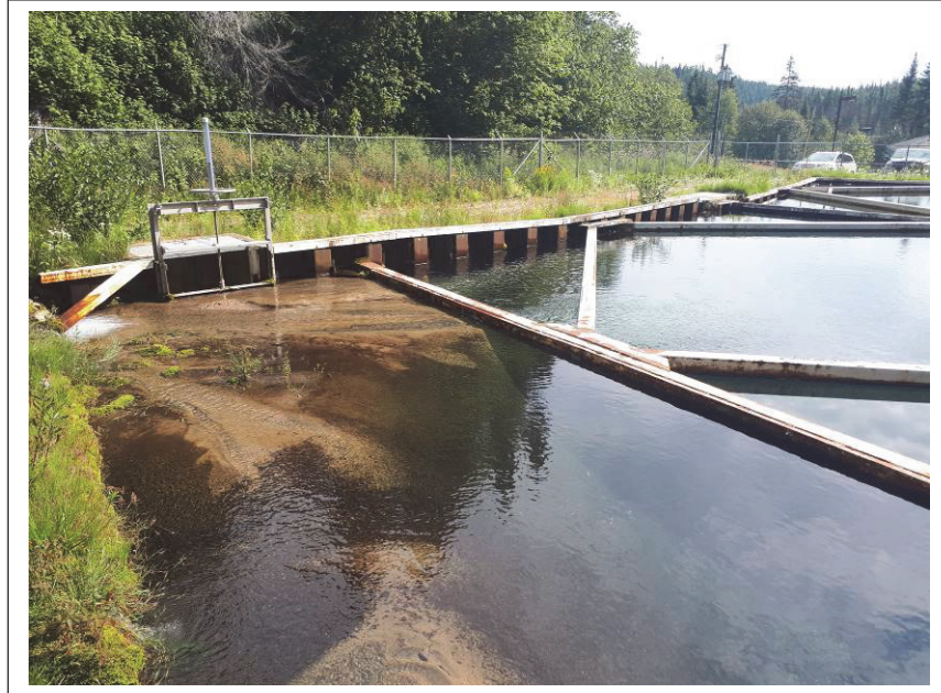
Photo 5 : Accumulation de sable dans le premier bassin de décantation - 2019-08-07
