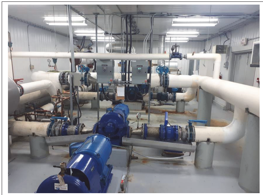
Photo 10 : Intérieur de la station de pompage - 2019-08-07
