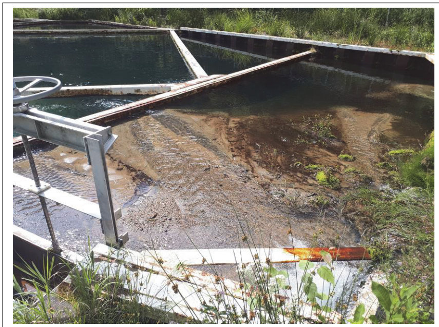
Photo 6 : Accumulation de sable dans le premier bassin de décantation - 2019-08-07
