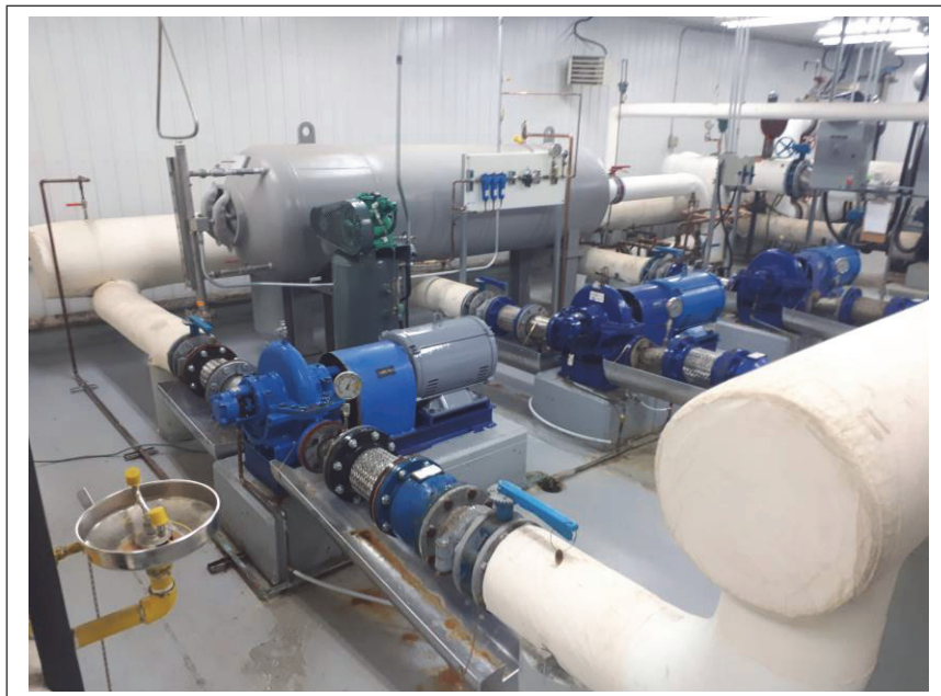
Photo 8 : Intérieur de la station de pompage - 2019-08-07
