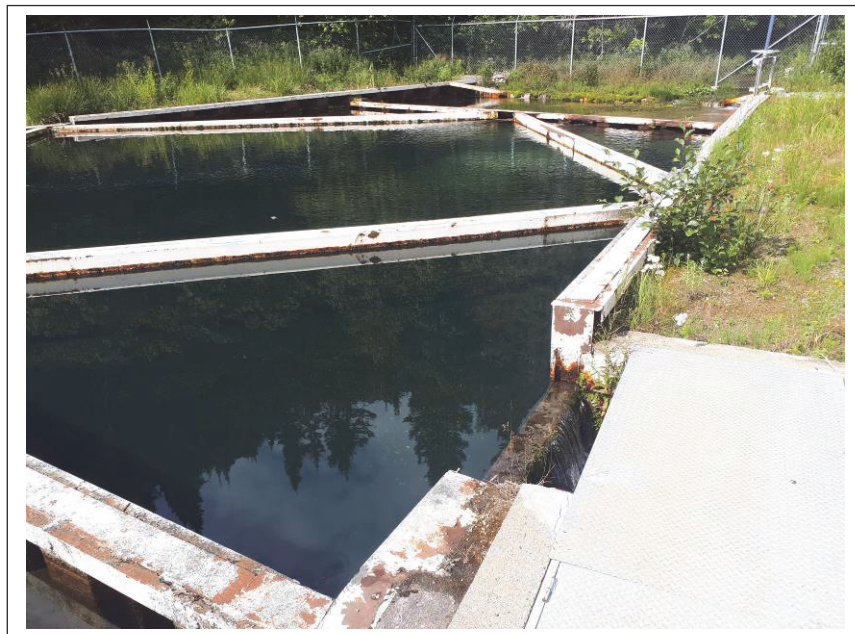
Photo 4 : Trop-plein du troisième bassin de décantation – 2019-08-07
