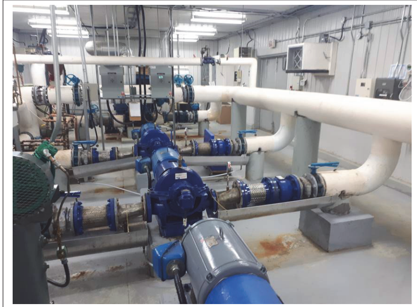
Photo 9 : Intérieur de la station de pompage - 2019-08-07
